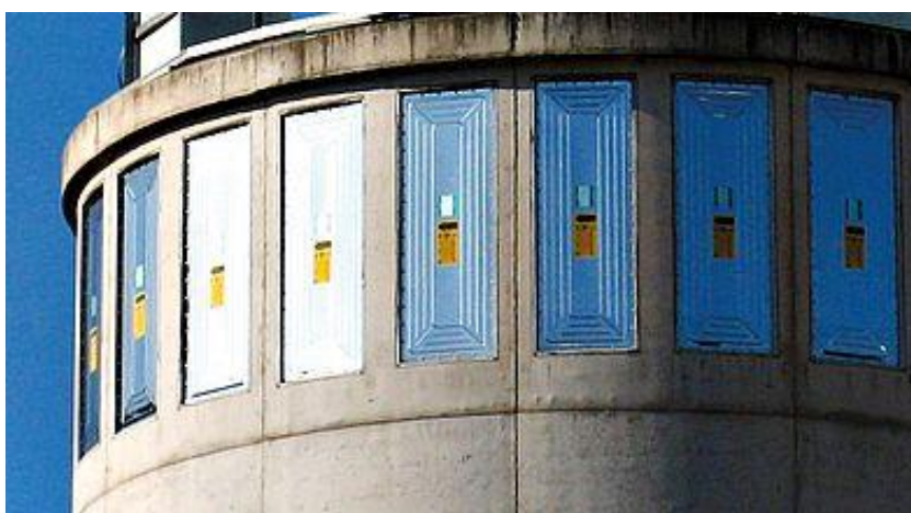
Figura 13 - Membrana metálica de ruptura para alívio de pressão.
