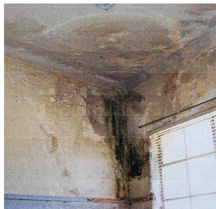
Figura 11 – Mofo e bolor nas paredes.
