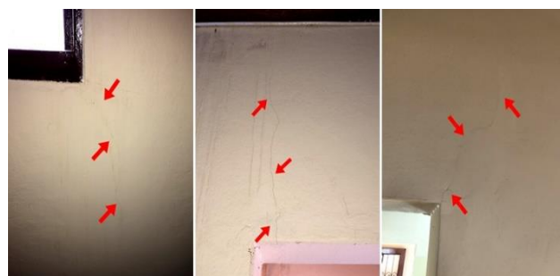
Figura 24 – Fissuração nos vértices de portas e janelas.
