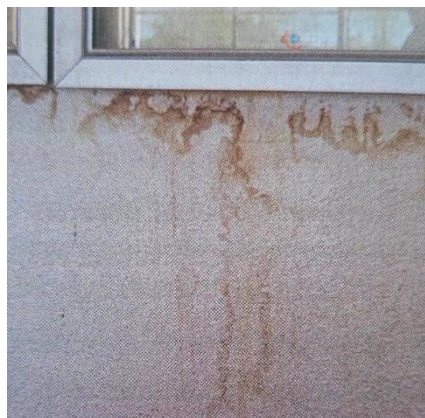
Figura 10 – Mancha de umidade nas paredes.
