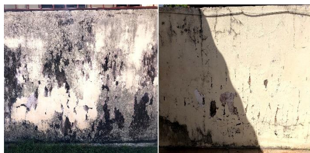
Figura 19 – Fissuração por movimentação higrotérmica na fachada e muros de divisa.
