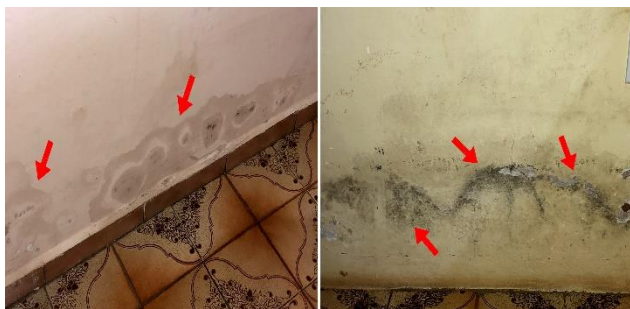
Figura 25 – Manchas de umidade, mofo e bolor nas paredes por infiltração do solo.
