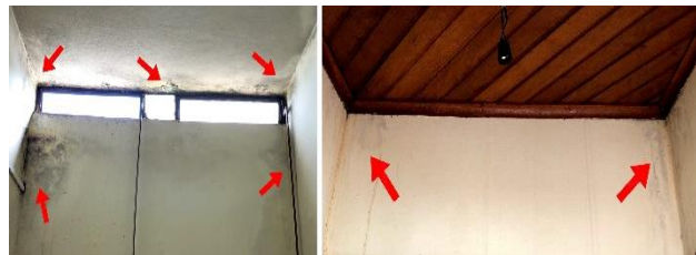
Figura 26 – Manchas de umidade, mofo e bolor nas paredes por infiltração da água da chuva.
