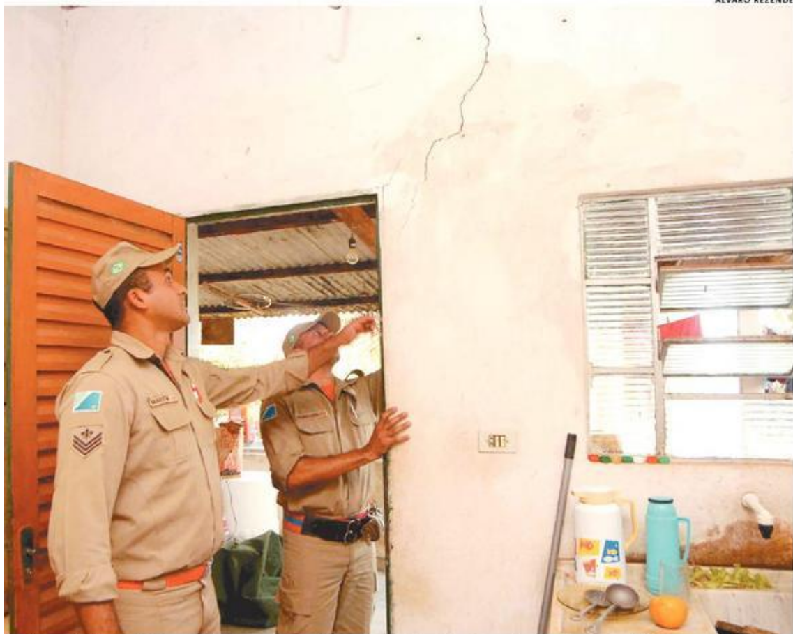
Bombeiros de Coxim vistoriam residência que apresentou rachadura depois do terremoto na região norte de MS, na segunda-feira
