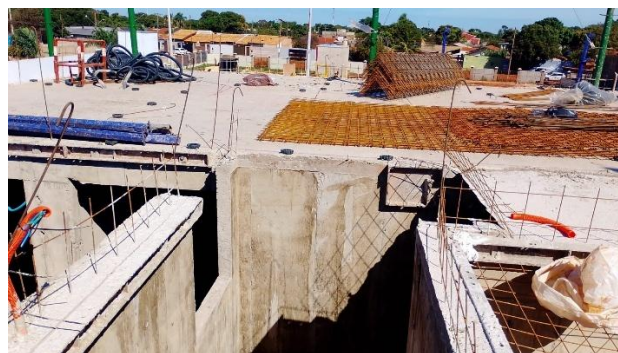
Figura 5 – Risco de queda.
