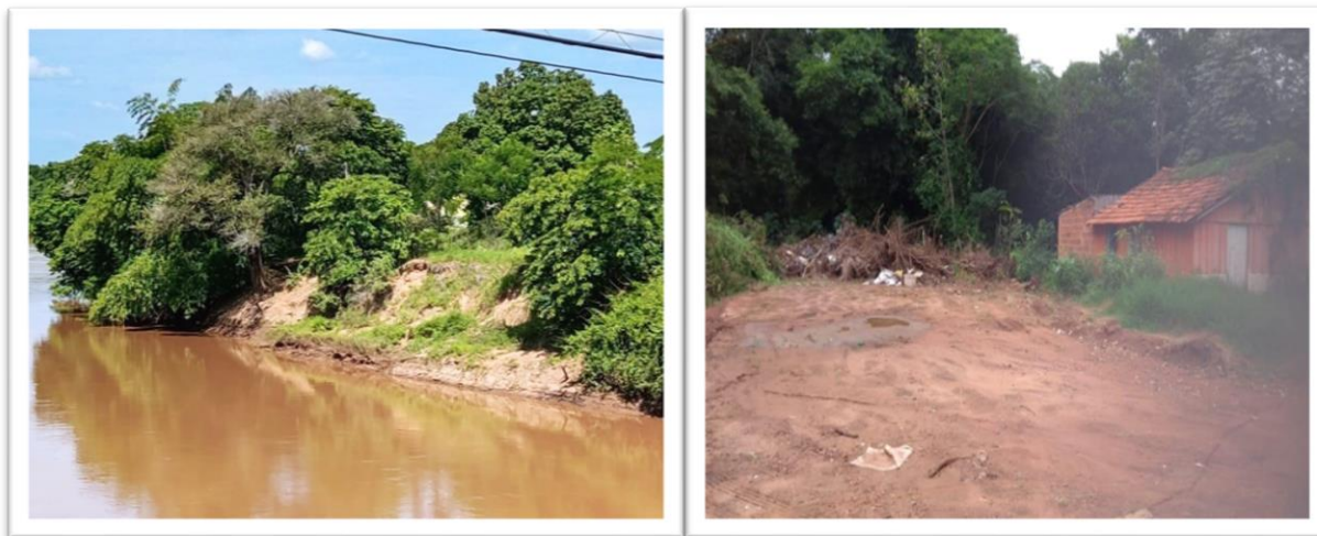
Figura 8 - Erosão causada pela falta de vegetação e aterro em casa instalada na planície de Inundação
