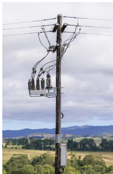
Figura 14: Religador com controle microprocessado instalado em poste.
