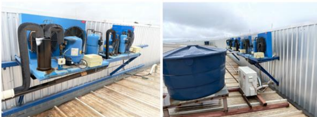
Figura 32 - Motor das câmaras frias
