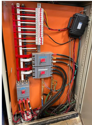
Figura 21 - Foto do equipamento instalado
