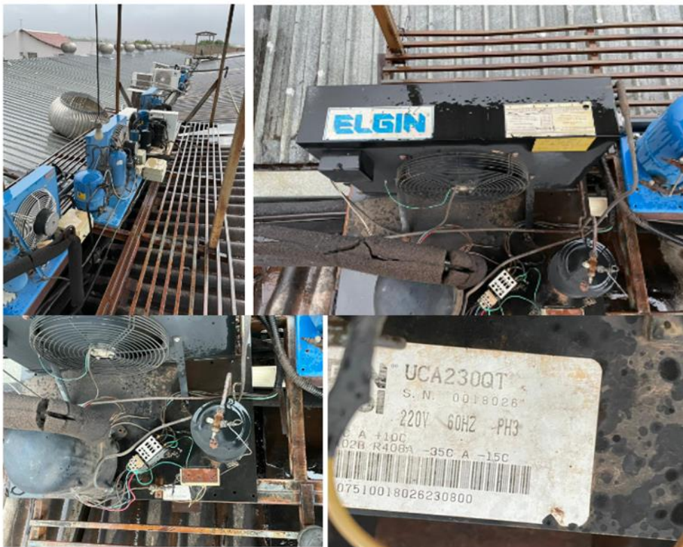
Figura 49 - Máquinas de câmaras frias
