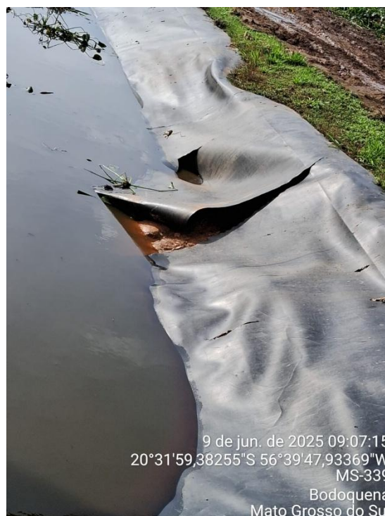
Figura 17. Lona da lagoa de maturação rompida. Fonte: Autor
