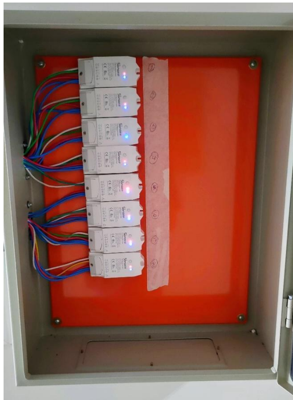
Figura 8 - Quadro com Sonoff POW R2 instalados.
