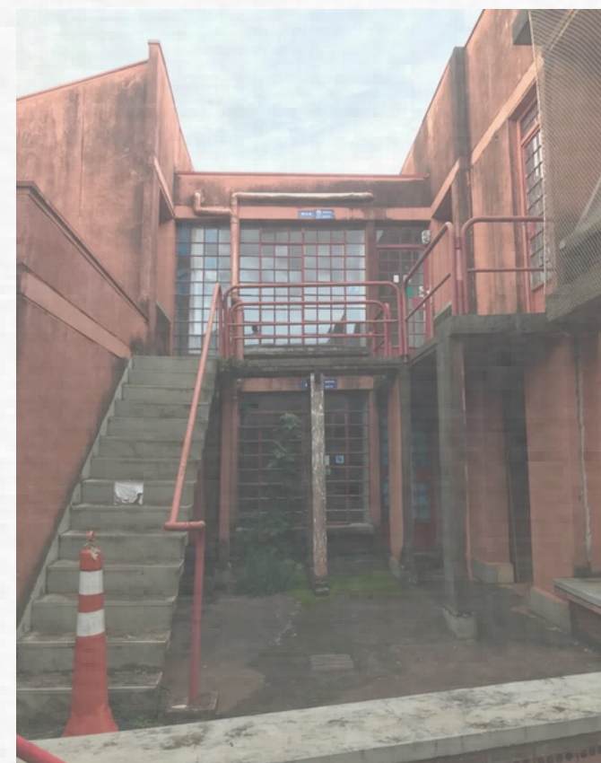
Figura 02 - Casa do bloco B, interditada por risco de desabamento na moradia estudantil da Unicamp.
