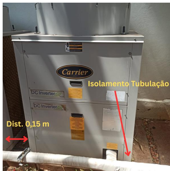
(b) Unidade condensadora com o isolamento térmico das tubulações de cobre (linha de sucção e líquido) e a tampa serviço para acesso ao compressor e pressostatos.
