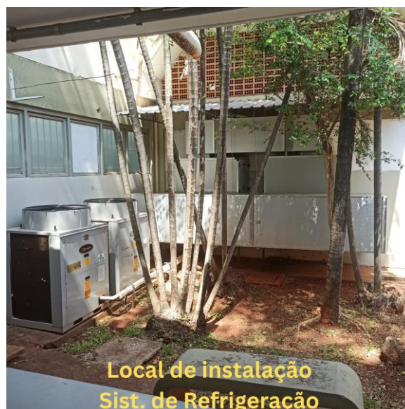
(h) Vista frontal da instalação externa do sistema de refrigeração central do DC.
