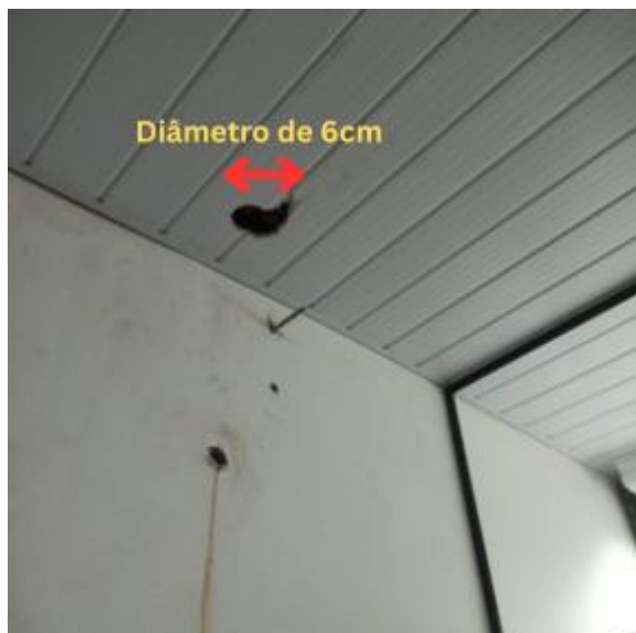
(g) Presença de abertura no forro de PVC do corredor frio do DC próximo porta corredor quente à esquerda.
