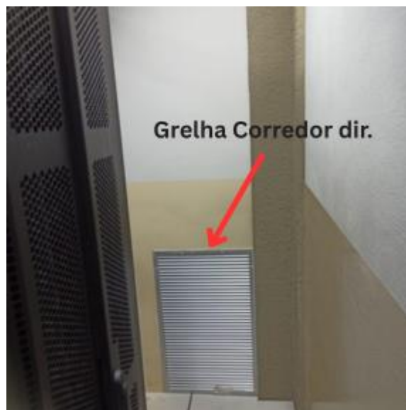
(b) Vista da grade de retorno posicionada no corredor quente, à direita, por onde o ar aquecido é conduzido ao sistema de refrigeração.
