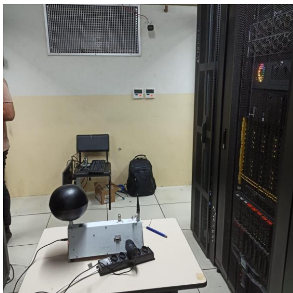
(a) Vista do confortímetro SENSU diante do climatizador do DC.
