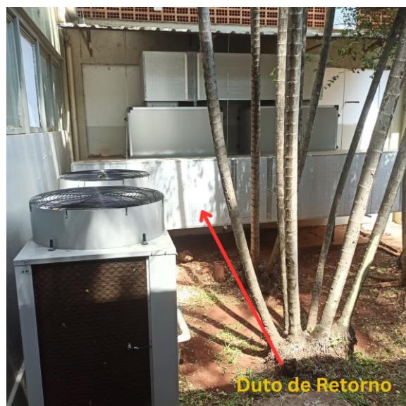
(d) Vista dos dutos de distribuição de ar e unidades condensadoras que compõem o sistema central de ar-condicionado.
