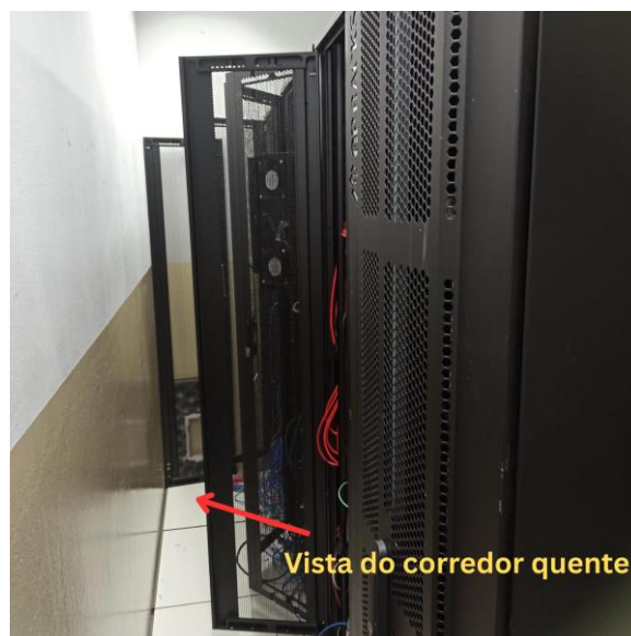
(d) Vista do corredor quente, mostrando as partes traseiras dos racks e o espaço destinado à manutenção e às conexões elétricas dos equipamentos.
