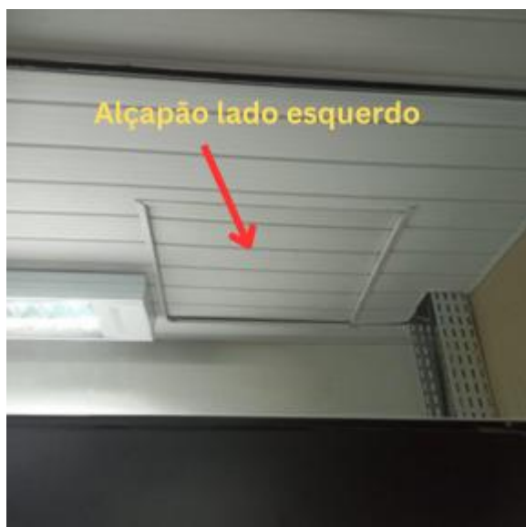
(a) Forro de PVC do alçapão destinado ao corredor quente à esquerda.
