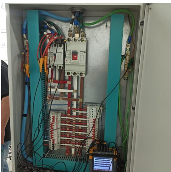
(a) Foto da instalação do Fluke no quadro geral do DC.
