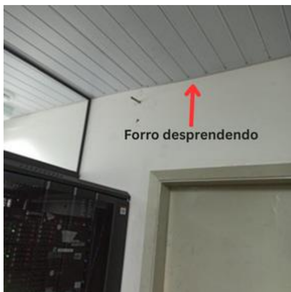
(e) Ocorrência de início de desprendimento do forro de PVC no DC próximo porta entrada.
