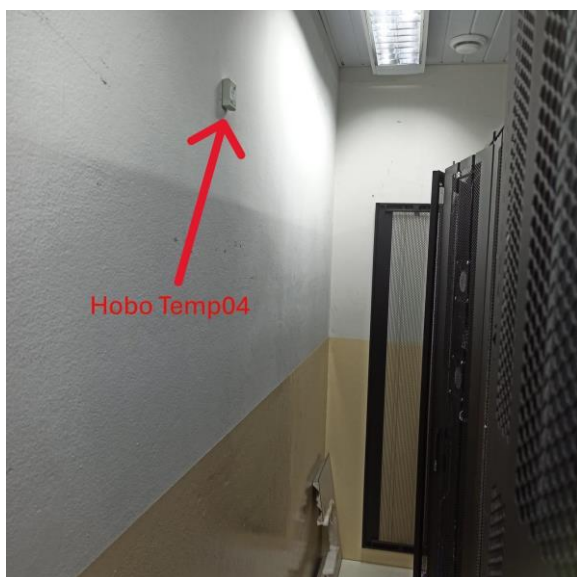
(a) Corredor quente, sensor HOB0_Temp04
