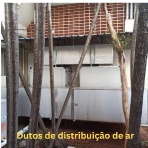
(c) Dutos de distribuição de ar e das unidades externas que compõem um sistema central de ar-condicionado.
