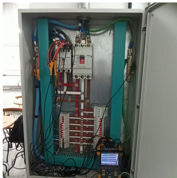
(d) Quadro de energia responsável pela demanda do DC.
