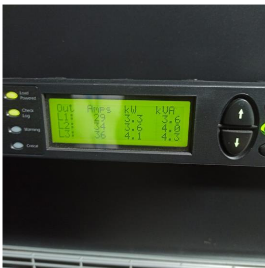
Figura 49. Registro fotográfico do painel de comando elétrico do rack no DC.
