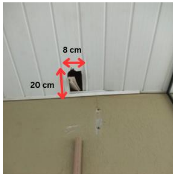
(h) Vista mais próxima da abertura do forro PVC no corredor frio situado no lado direito.
