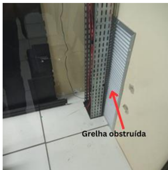
(f) Obstrução da passagem do ar quente pela eletrocalha 100x50 na grelha instalada.
