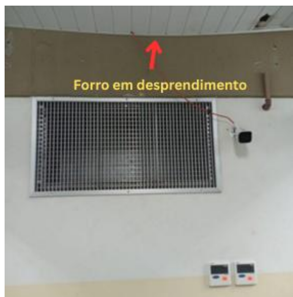
(d) Possível desprendimento do forro PVC no DC no corredor frio.
