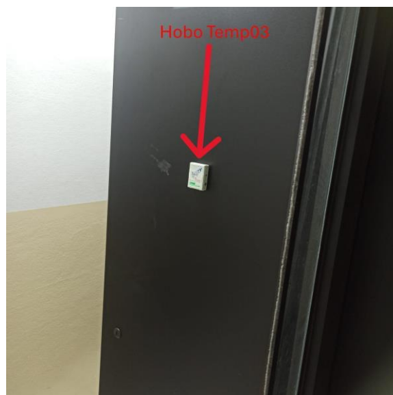
(b) Corredor quente, sensor instalado próximo da porta de acesso.
