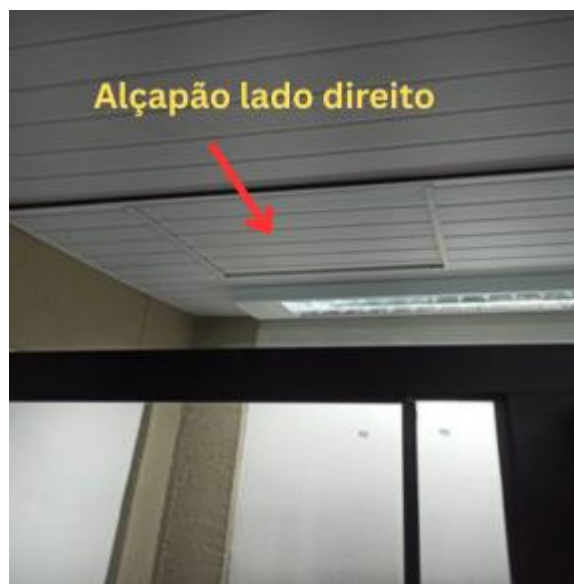
(b) Forro de PVC do alçapão utilizado no corredor quente à direita.
