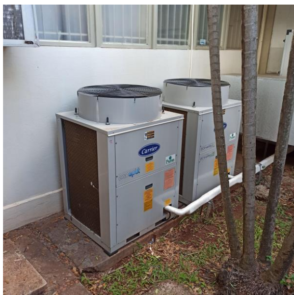
(a) Vista da unidade condensadora de um sistema de ar-condicionado split Carrier, instalada externamente para dissipar o calor do sistema.
