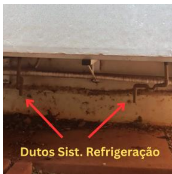
(f) Pontos de drenagem do sistema de distribuição de ar condicionado.
