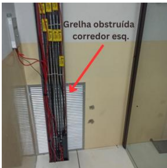
(a) Vista da grade de retorno posicionada no corredor quente, à esquerda, por onde o ar aquecido é conduzido ao sistema de refrigeração.
