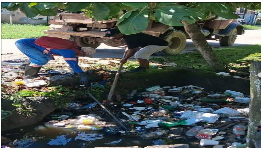
Figura 9 — Lixo na rede drenagem Fonte: Prefeitura Municipal de Tabatinga-AM
