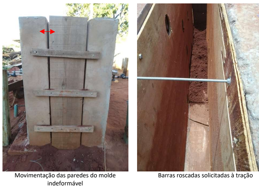
Figura 23. Falha e solução para o travamento superior no molde indeformável.
