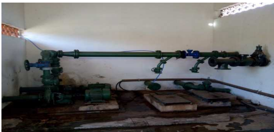
Figura 11. Conjunto motor bomba EAT-001 (um ativo e outro de reserva).
