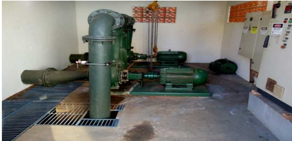
Figura 12. Conjunto motor bomba EAT-002 (um ativo e outro de reserva) e quadro de comando (ETA-002).
