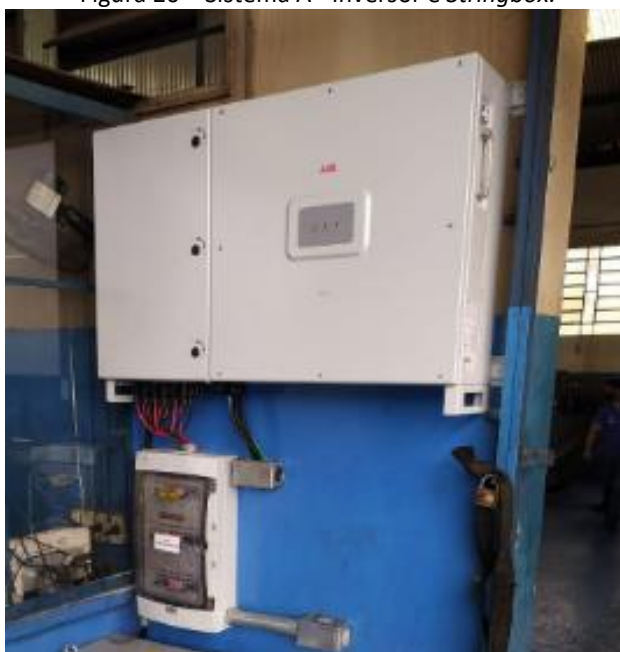
Figura 20 – Sistema A - Inversor e Stringbox .
