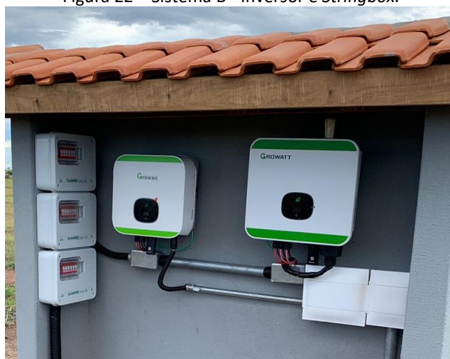
Figura 22 – Sistema B - Inversor e Stringbox.
