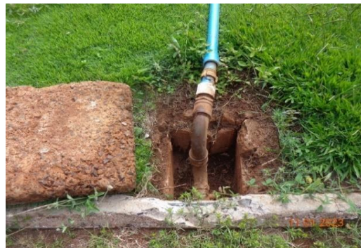
Figura 17. Registro de 2" para irrigação do gramado
