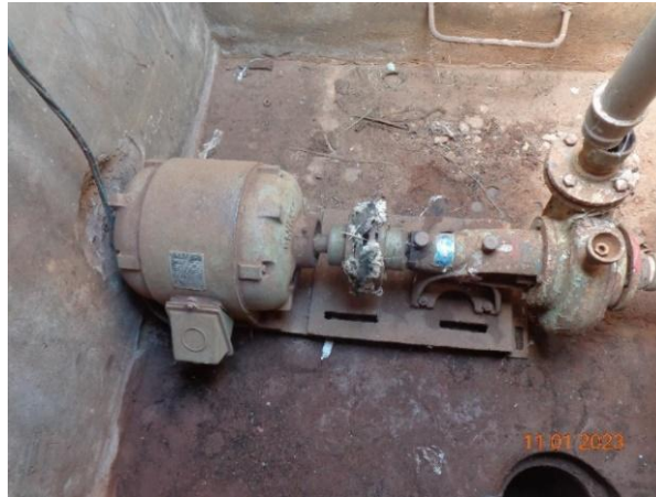
Figura 19. Bomba de recalque de 15 cv para irrigação do gramado
