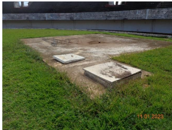
Figura 20. Reservatório subterrâneo para irrigação do gramado
