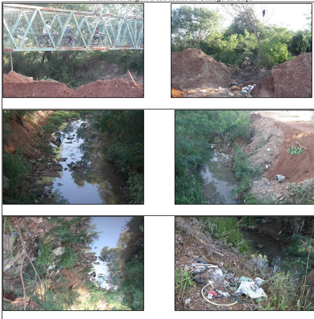
Prancha 11: Esgoto a céu aberto no Córrego da Onça
