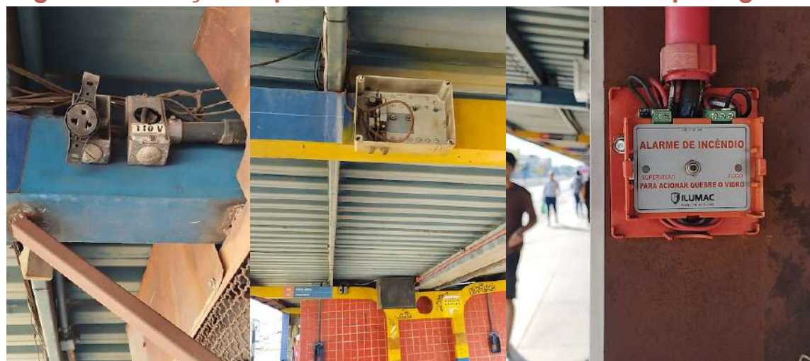
Figura 44 - Fiação Exposta e Alarme de Incêndio Desprotegido
