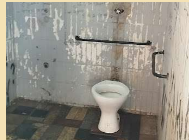
Figura 49. WC's PCD's Danificados
