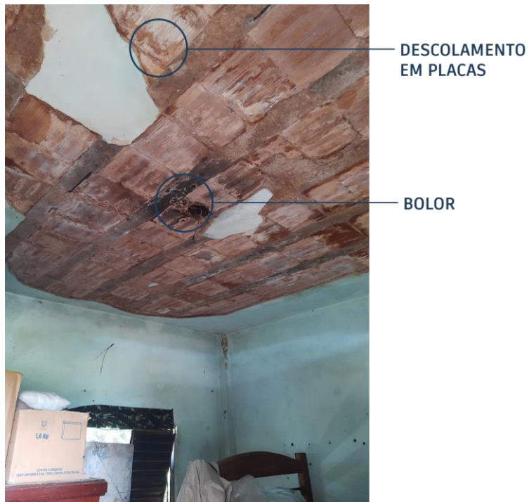
Figura 14. Descolamento do reboco da laje de cobertura
