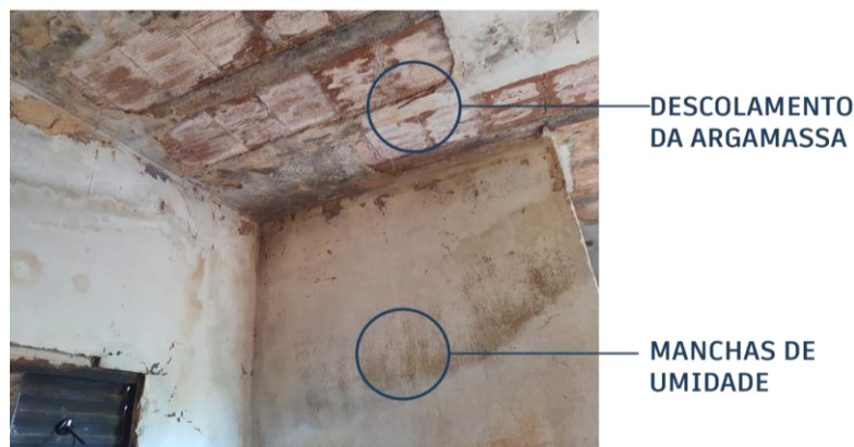
Figura 17. Manchas de umidade.
