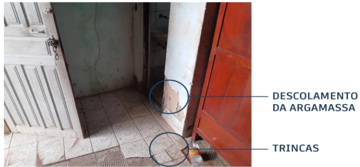
Figura 13. Descolamento do reboco e piso
