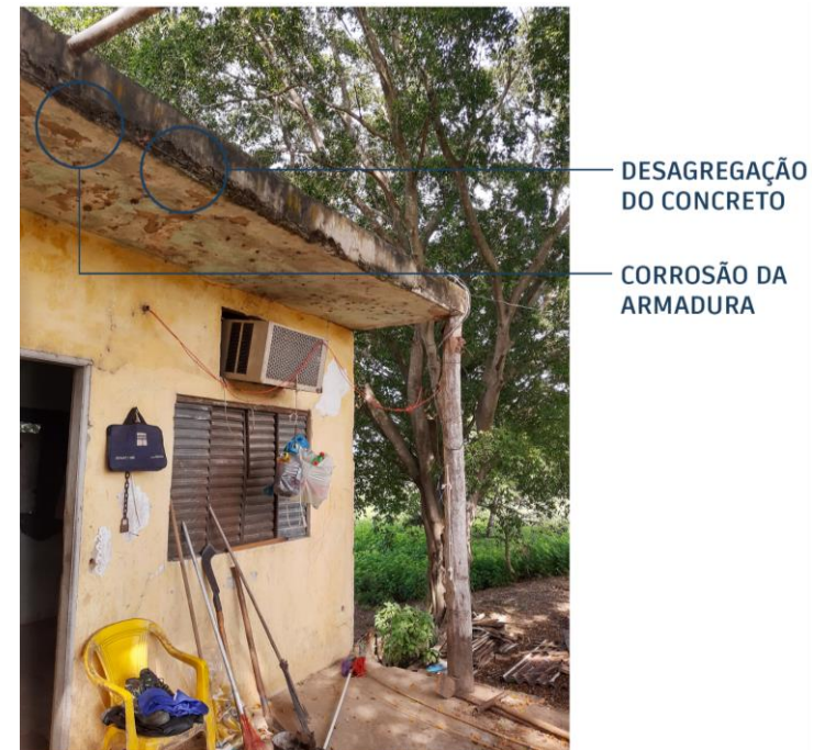
Figura 15. Corrosão da armadura da laje
