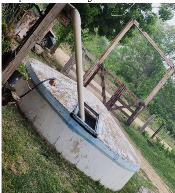
Figura 13 Cisterna para captação e aproveitamento de água da chuva
