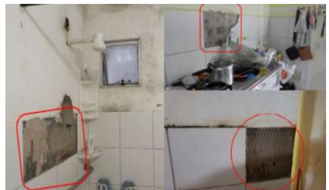
Figura 4 – Descolamento da cerâmica do banheiro e cozinha.
