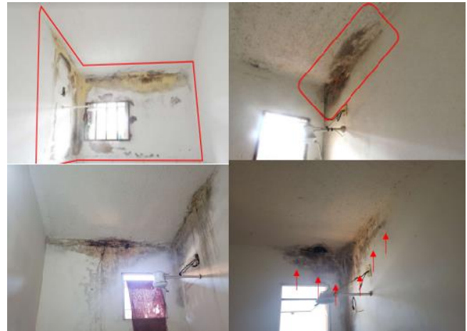
Figura 3 – Infiltração e mofo na laje
