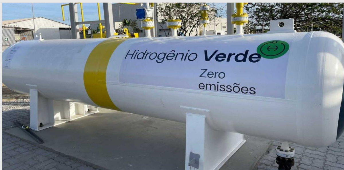
Figura 39: armazenamento do gás hidrogênio
