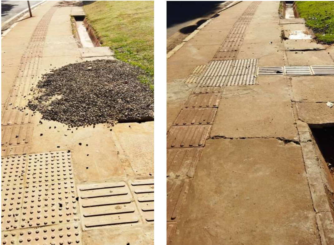
(a) Calçamento parcialmente obstruído por pedras.
