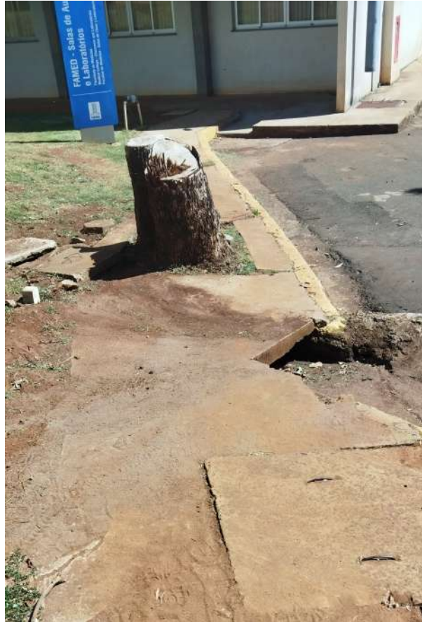
Figura 35 – Calçada sem infraestrutura acessível. Descrição da figura: Calçada sem piso tátil, com falhas e um tronco de árvore bloqueando a passagem.
