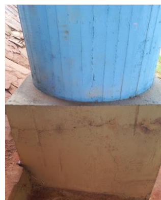
Figura 9 – Fissuração e degradação do concreto na base do pilar. Fonte: Autora
