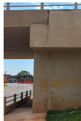
(b) Trinca na cabeceira do viaduto.
