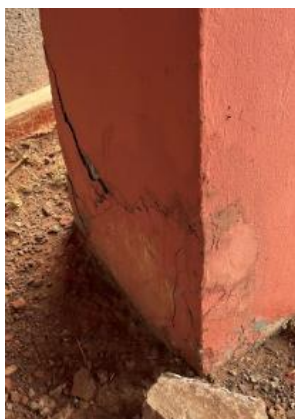
Figura 16 – Oxidação da armadura na base do pilar. Fonte: Autora
