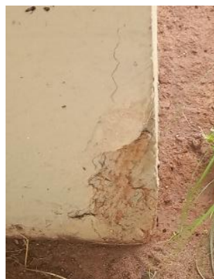
(a) Degradação do concreto na base do pilar.
