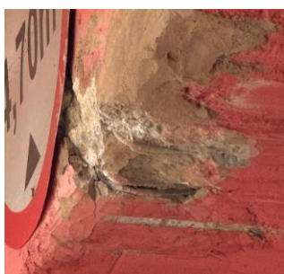
Figura 15 – Armadura exposta e cobrimento insuficiente. Fonte: Autora
