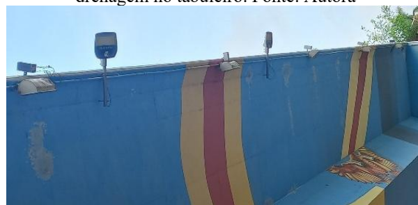
Figura 8 – Manchas de infiltrações e ausência de drenagem no tabuleiro. Fonte: Autora
