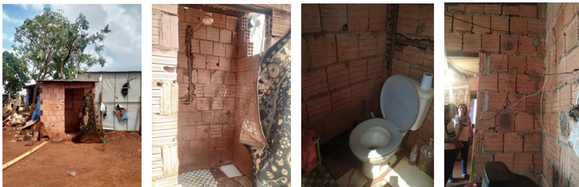
Figura 7. Levantamento de dados na Comunidade Novo Dia – banheiro externo inacabado
