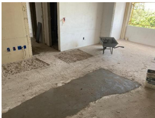
Figura 1 — Retrabalho no contrapiso T1.
