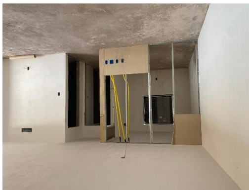
Figura 4 — Drywall sem terminalidade T1.
