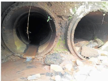
Prevenção. Dnit iniciou, ontem, os trabalhos para substituir galeria que ameaçava destruir estrada
