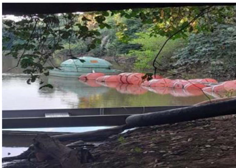
Figura 3: Estação de captação de água do rio Taquaruçu para o abastecimento de Anastácio
