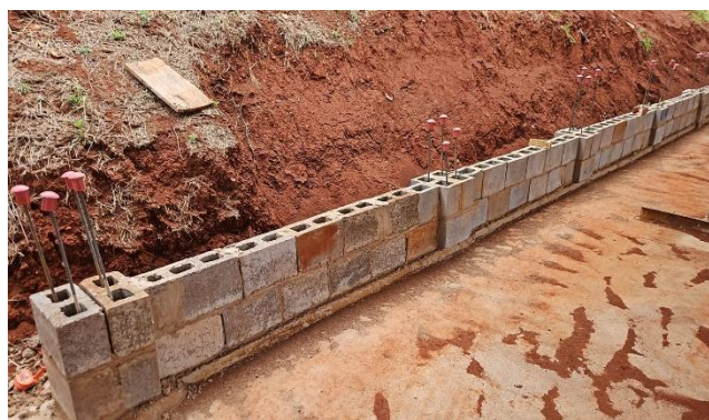
Figura 18 - Muro de Arrimo com peças remanescentes (Fonte: Autoral; Data: 17/07/2025)
