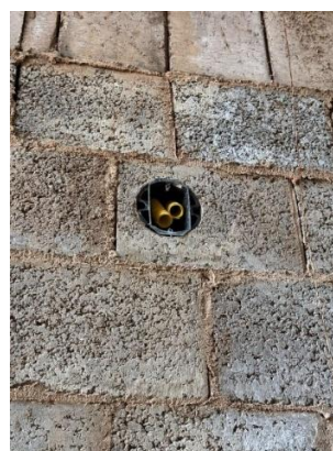
Figura 16 - Furo com instalação prediais (Fonte: Autoral; Data: 17/07/2025)
