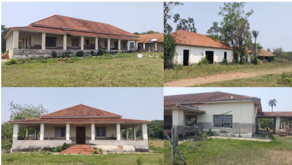
Figura 26 - Área para instalação da Escola de Desenvolvimento Integral da Criança e Adolescente na Reforma Agrária (EDICARA)
