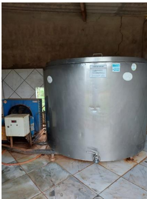
Figura 22-Assentamento Arizona/Andradina (SP) – Resfriador comunitário COAPAR
