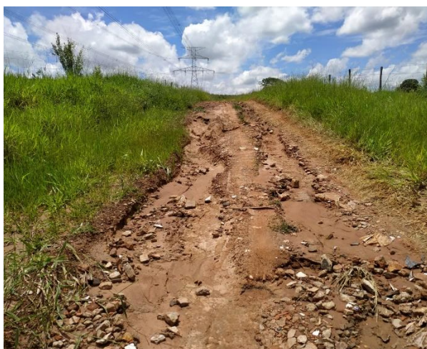
Figura 17- Assentamento Arizona/Andradina (SP) - Estrada Interna após chuvas
