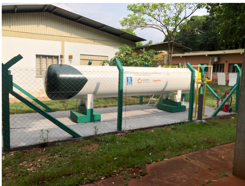
Figura 11 – Reservatório de GLP LAMOSSE
