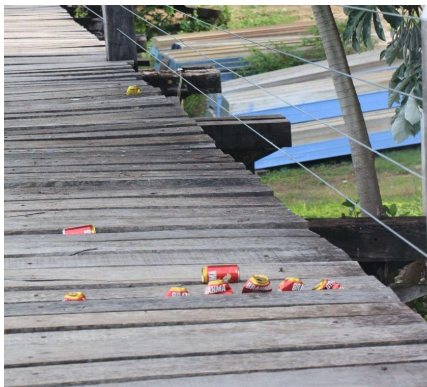
Figura 17 – passarela sob rio Miranda, com latinhas jogadas
