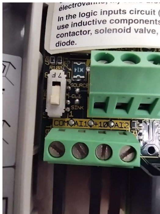
Figura 38 - Bornes de controle do inversor do BATLAB.
