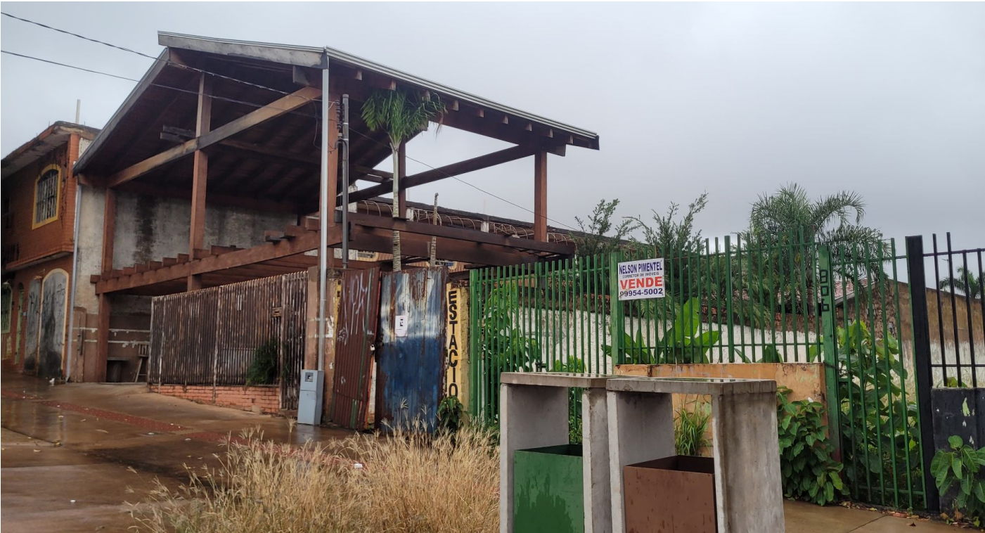
Figura 41 - Estrutura de imóvel abandonado na Rua Aquidauana
