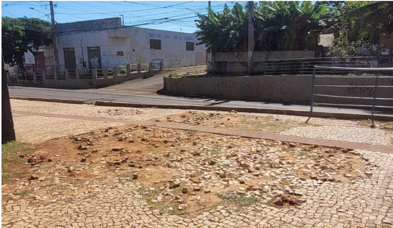
Figura 10: Revestimento de pedra portuguesa deteriorado.
