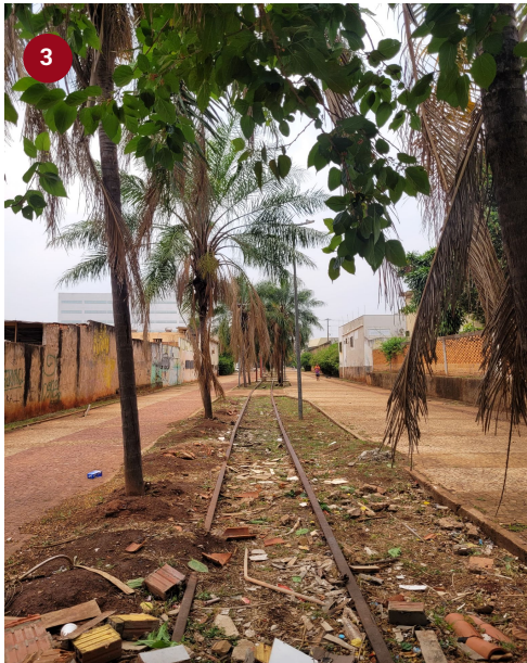
Figura 85: Trilho do trem com calçamento deteriorado Fonte: Acervo pessoal, 2025.
