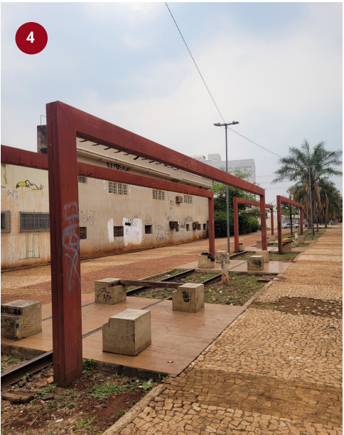
Figura 86: Pergolado e mobiliários deteriorados e/ou danificados. Fonte: Acervo pessoal, 2025.
