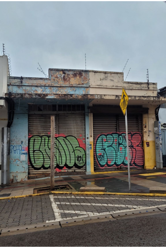
Figura 42 - Imóvel comercial abandonado
