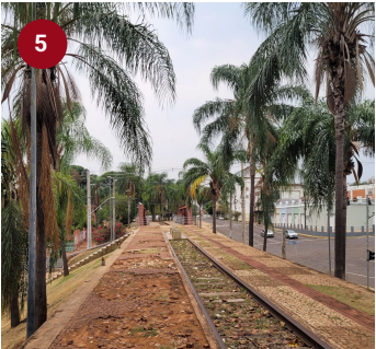
Figura 71 - Trilhos com calçamento degradado
