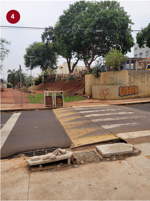
Figura 91: Mobiliário danificado Rua Dom Aquino Fonte: Acervo pessoal, 2025.
