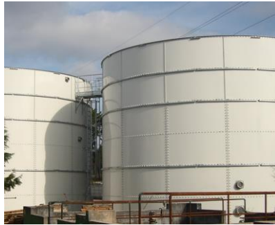
Figura 18 – Tanque de armazenamento
