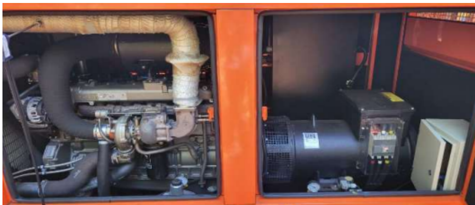
Figura 4 – Grupo Motor Gerador Utilizado
