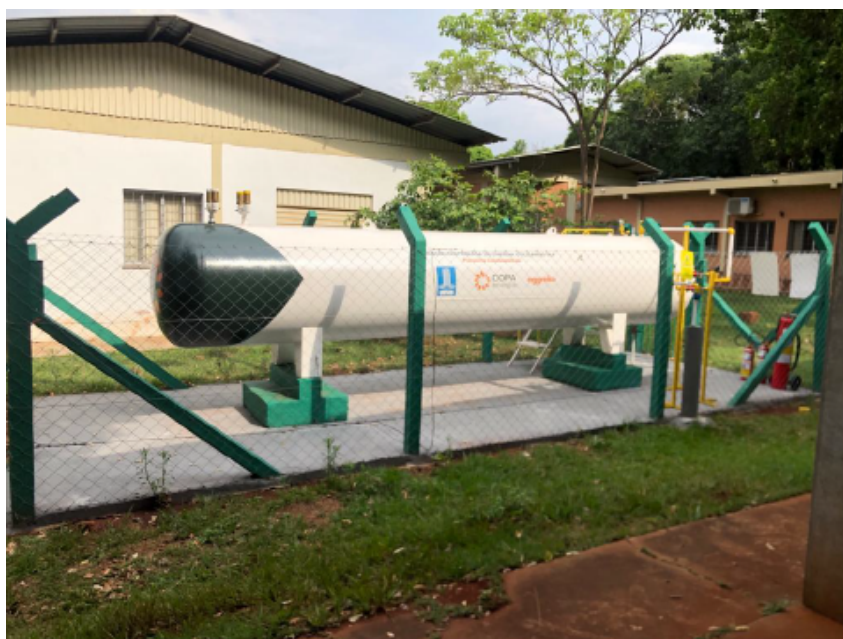
Figura 9 – Reservatório de gás LAMOSSE
