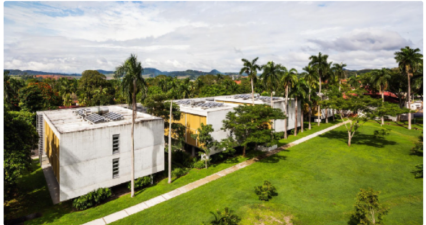
Figura 19 – Vista aérea placas solares e boilers dos blocos dos dormitórios da ciudad del saber
