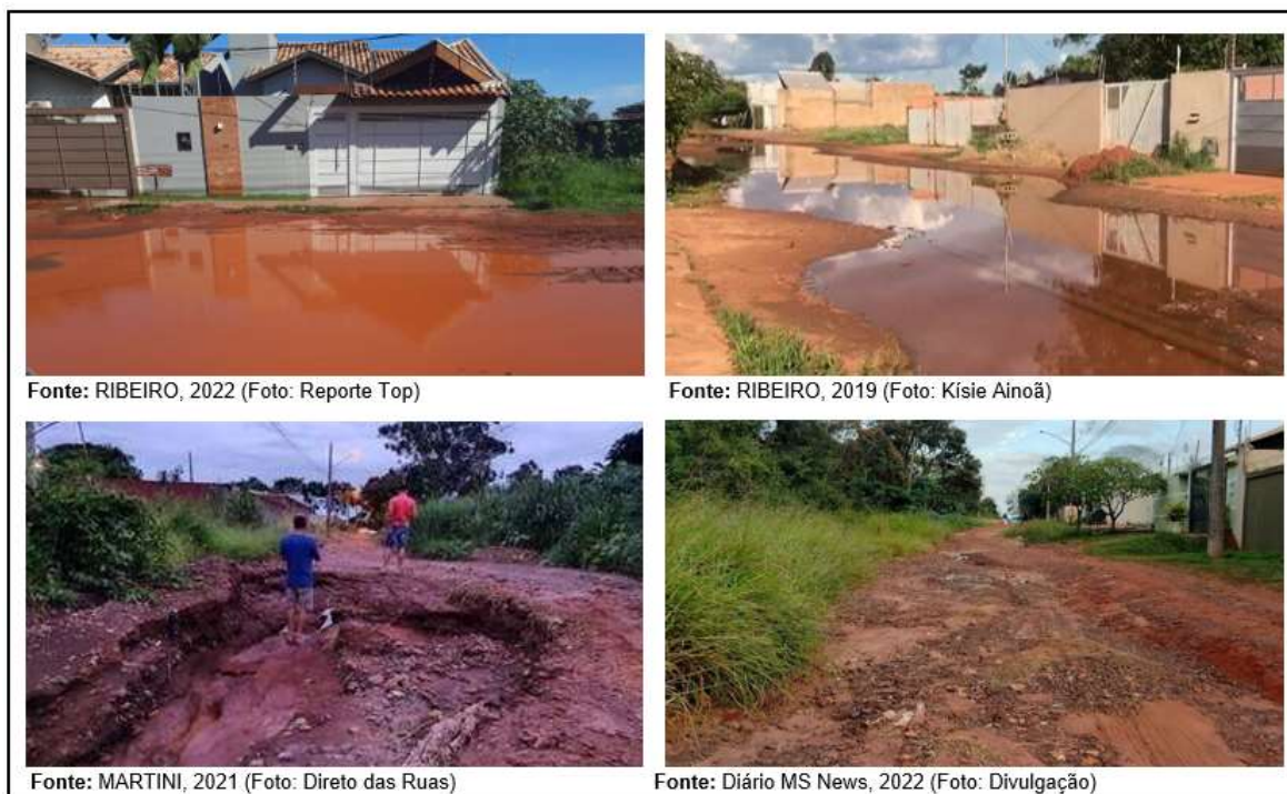
Figura 8: Problemas causados pelas chuvas intensas no bairro Rita Vieira.
