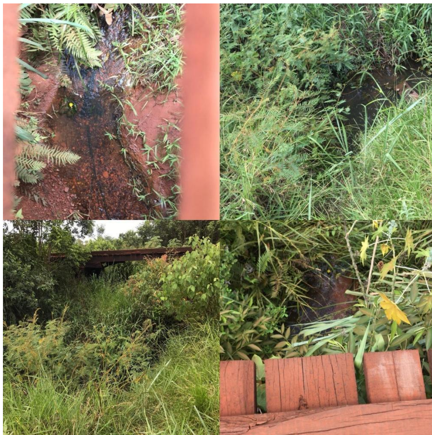
Figura 16; Ponte com indícios de esgotamento hídrico na região de Selvíria/MS.
