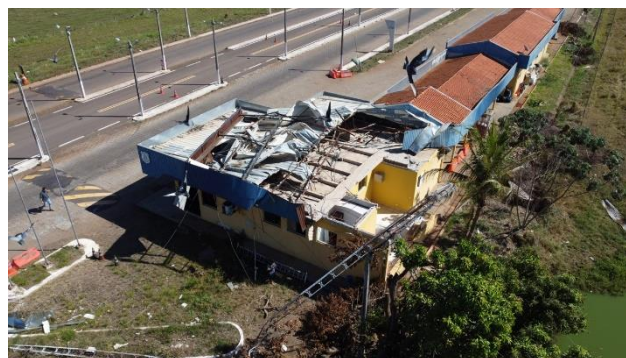
Figura 03 – Vista área da estrutura colapsada.
