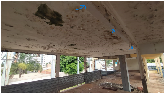
Figura 1 - Fissuras por flexão
