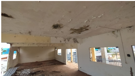
Figura 2 - Mofo e descolamento de placas
