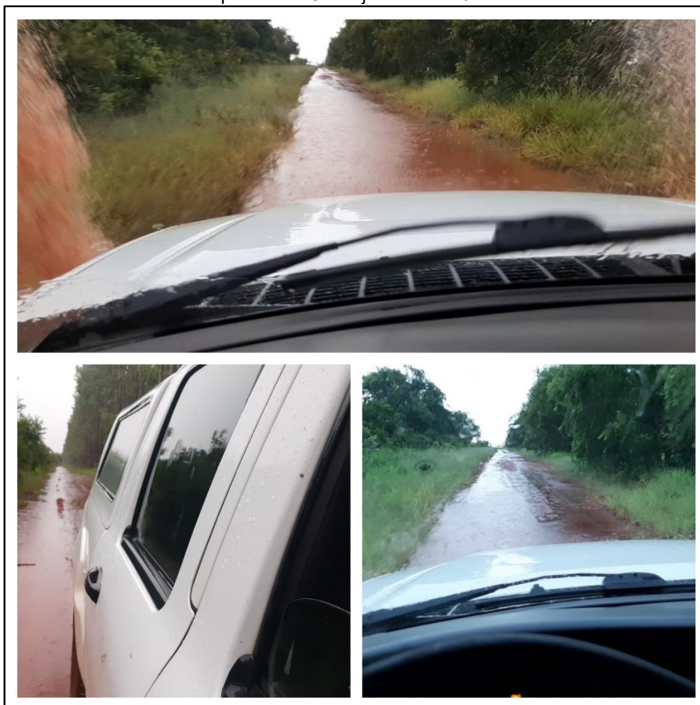
Figura 31 – Escoamento superficial concentrado (córrego temporário) sobre a pista de rolamento próximo à UA1 - janeiro de 2024
