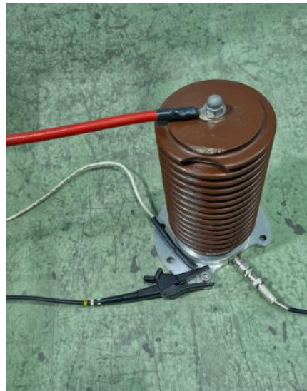
Figura 20- Capacitor Acoplador Com Suas Respectivas Conexões (Alimentação E Aterramento)
