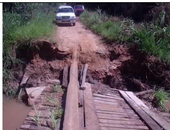
Figura 19 - Ponte localizada no entorno da Reserva, avariada pela força d'água do córrego Beleza, após rompimento de açudes à montante (maio/2006)
