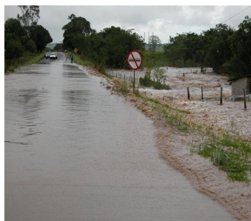
Figura 18 - Rod. BR 158 após rompimento de açudes à montante no córrego Beleza _ próximo à ponte do rio Verde (maio/2006)
