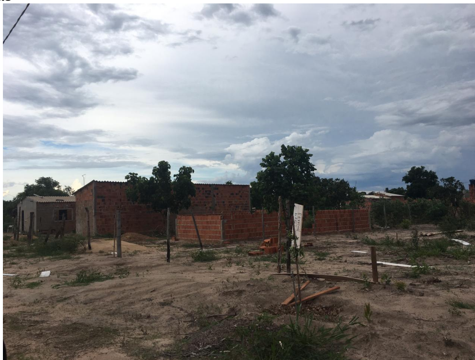
Figura 25 - Distrito da Véstia: loteamento Guadalupe do Alto Paraná - construções precárias
