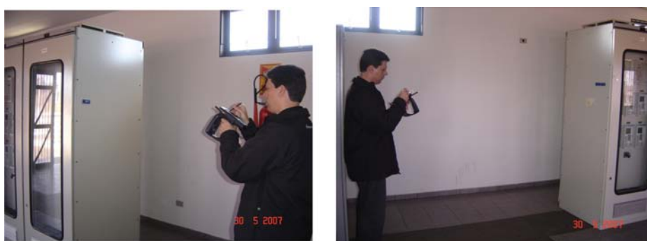
Figura 5.2: Casa de Comando (Subestação Modelo)
