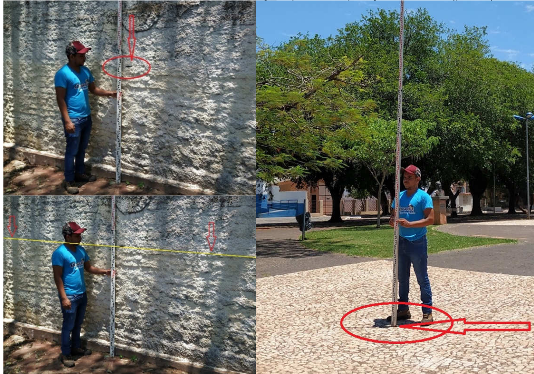
Foto 3 - Marca de referência da inundação, para interpolação de cotas (painel)
