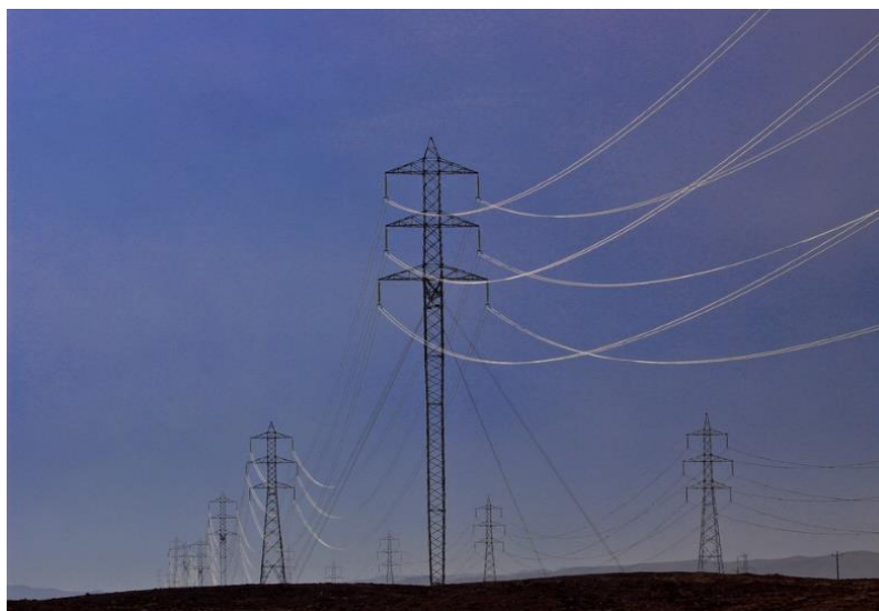
Figura 3 - Fios elétricos. Fonte: http://www.fotocommunity.es
