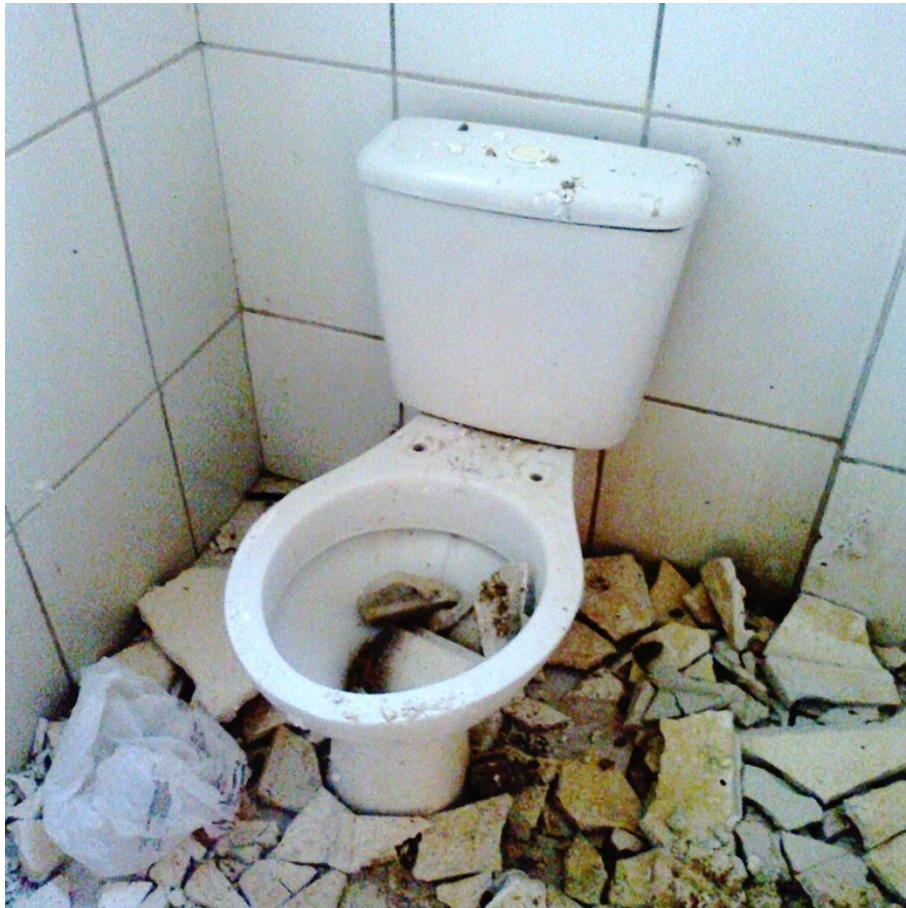
Figura 15. Apartamento abandonado - Condomínio Pavão.
