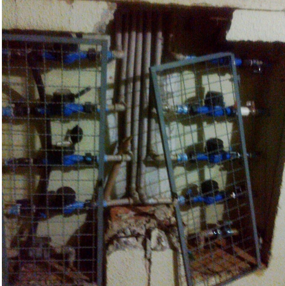
Figura 16. Registros de água depredados - Condomínio Pavão.
