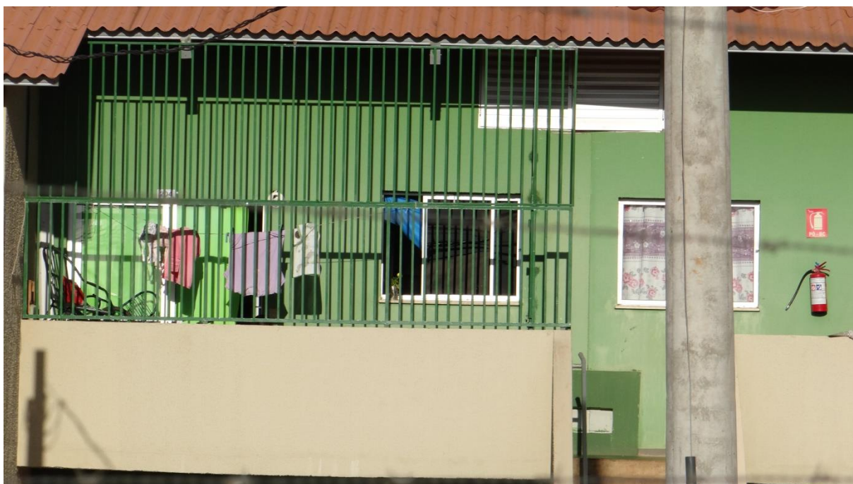
Figura 13. Grade de segurança instalada por um morador – Condomínio Parda Fonte: FERREIRA, L. A., 2015.
