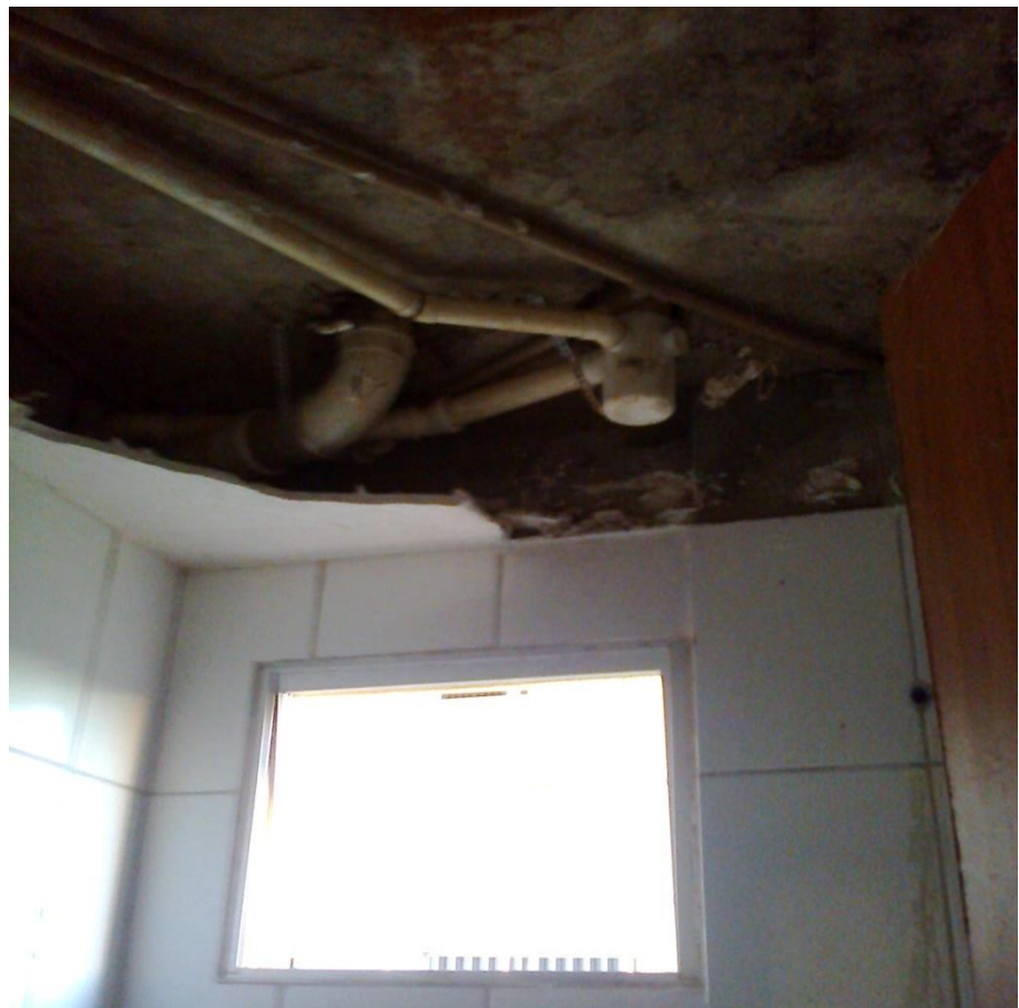
Figura 14. Laje do banheiro de um Apartamento abandonado – Condomínio Pavão. Fonte: FERREIRA, L. A., 2015.
